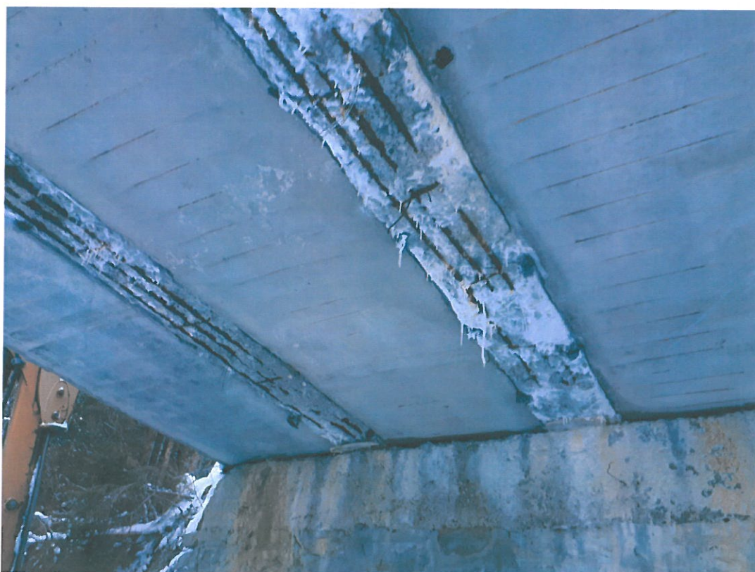
Foto 7: Detaliu aspect degradari intrados.
