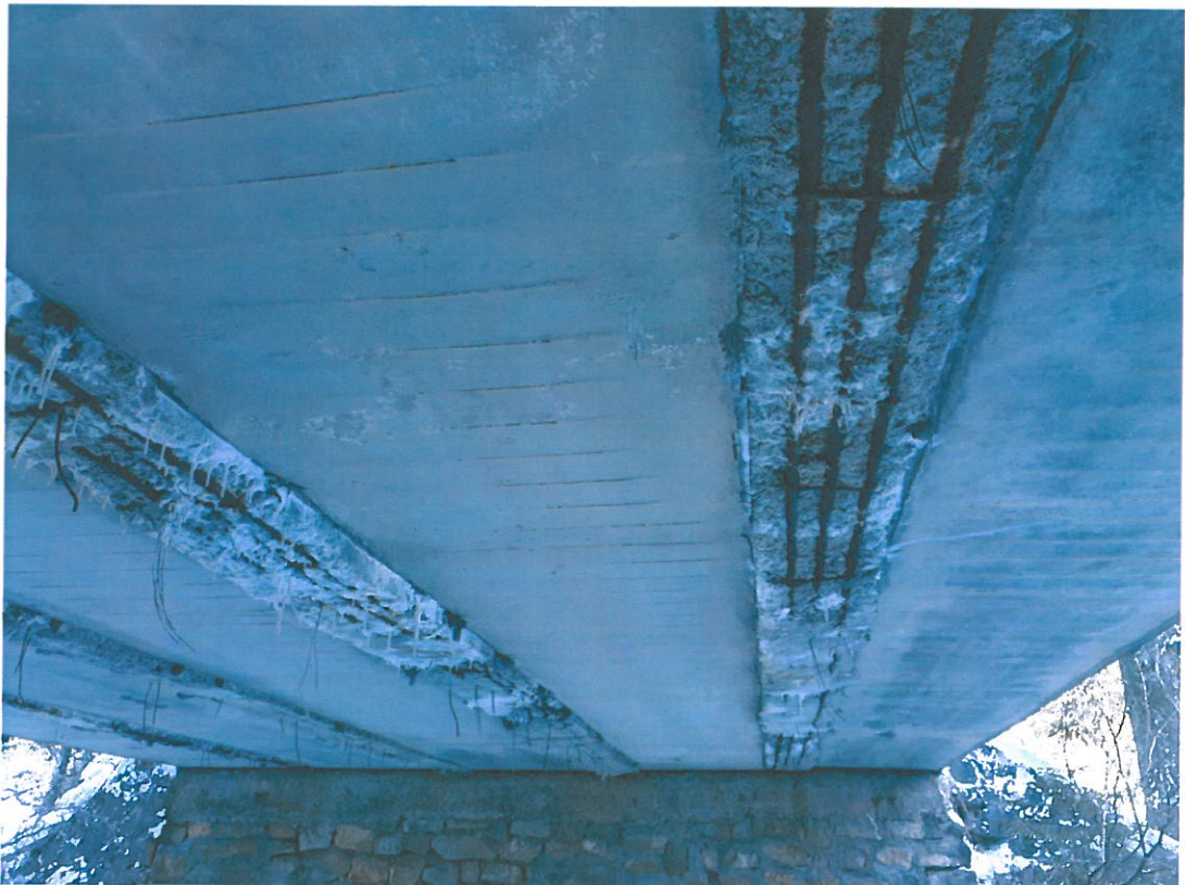
Foto 6: Vedere de ansamblu intrados cu aspectul degradarilor.
