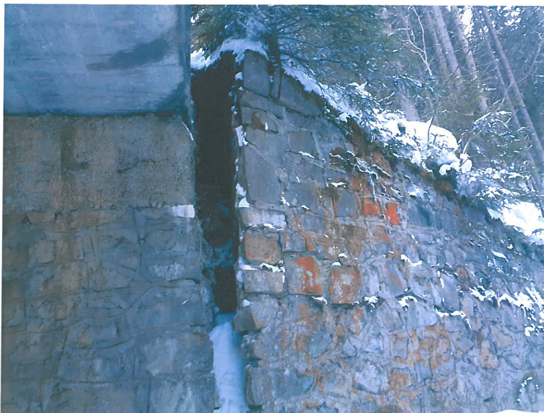
Foto 9: Detaliu aspect desprindere aripa.
